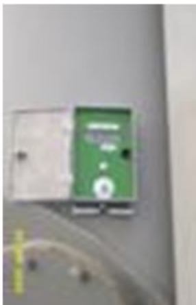
Рисунок 5 – Установка "аналогового порогового индикатора" на корпус трансформатора
