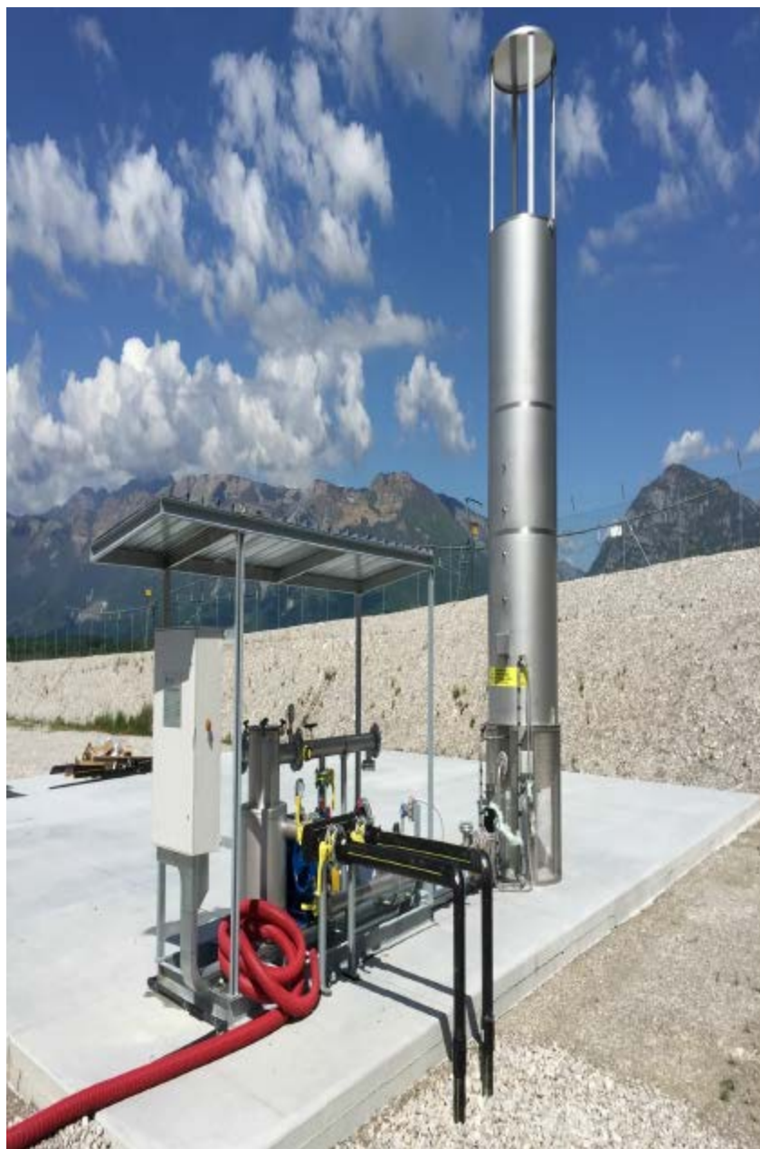
Рисунок 25 - Установка высокотемпературного сжигания свалочного газа
