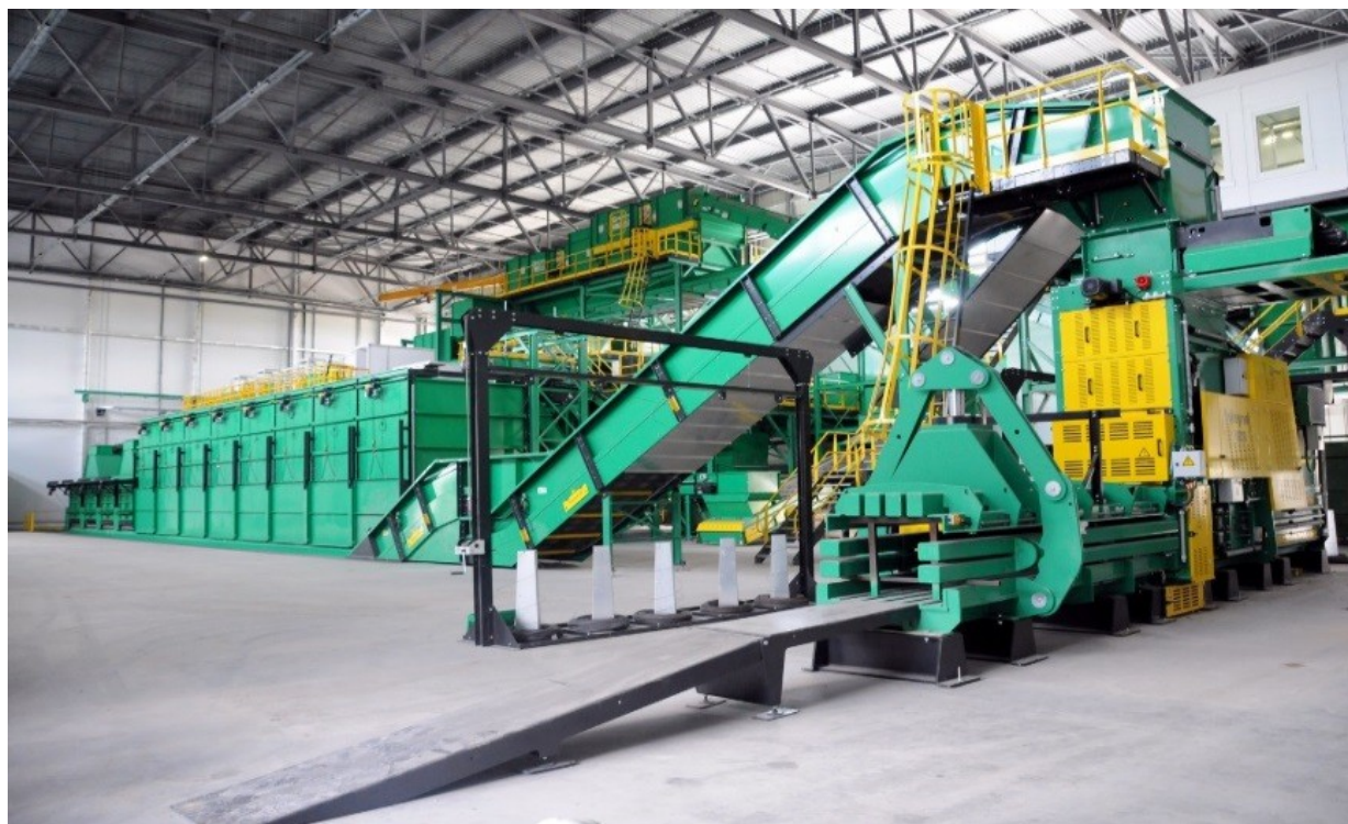
Рисунок 22 - Общий вид полуавтоматической линии сортировки
